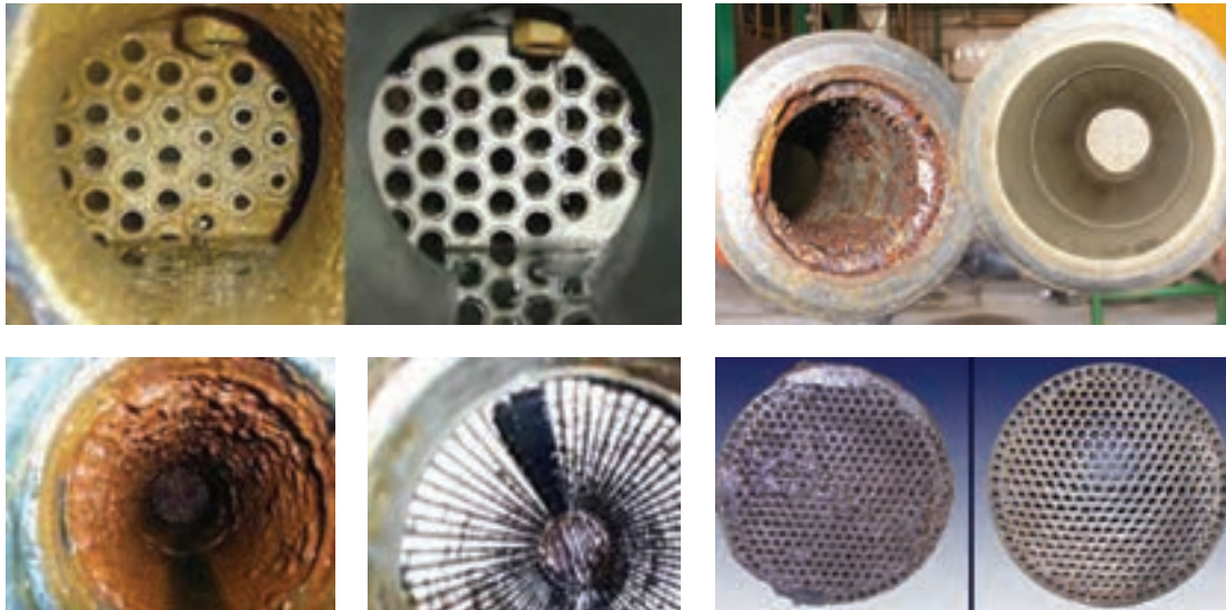
شکل ۲۲- برخی از تجهیزات قبل و بعد از شست و شوی شیمیایی
