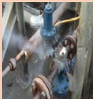
نشستی از خطوط لوله
