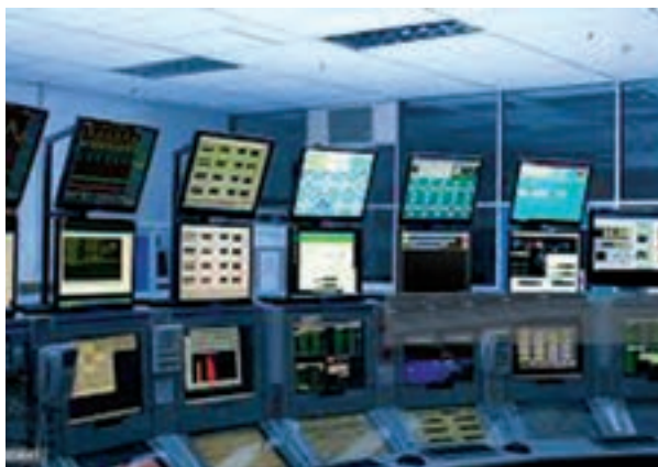
شکل ۲۸- نمایی از اتاق فرمان واحد
