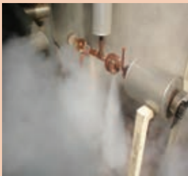
نشستی از اتصال در خط لوله
