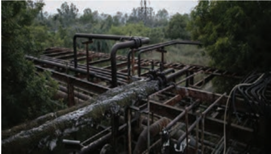
شکل ۸- خطوط لوله آسیب دیده در کارخانه یونیون کار باید
