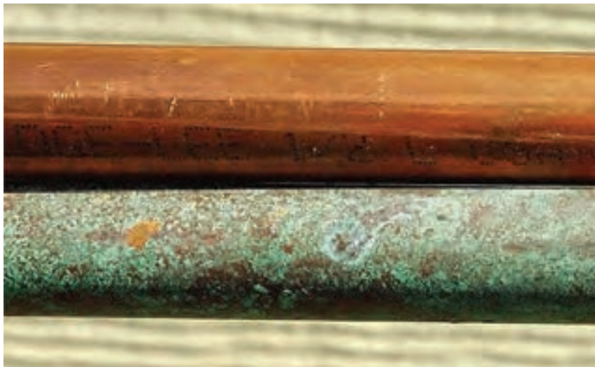
شکل ۳۳- تغییر رنگ لوله مسی در مجاورت هوای مرطوب
