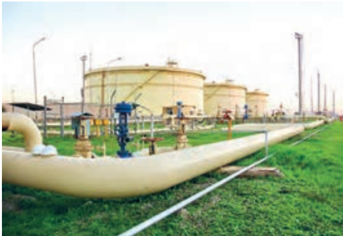
شکل ۲۱- نمایی از خطوط انتقال سوخت
